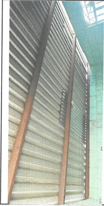
Foto 3:, vista de techo en mal estado con una lamina para parchar filtración de agua e instalación eléctrica únicamente sobre puesto
