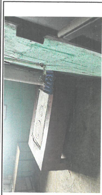
Foto 2: vista de plancha rural a sustituir completamente
